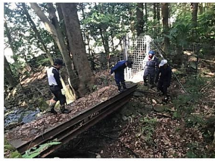
鳥獣害防護柵の保守管理
