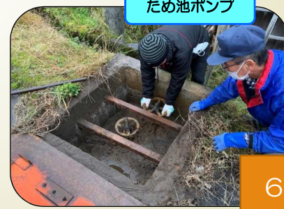
ため池ポンプ
