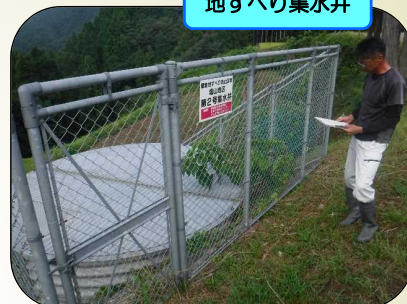
地すべり集水井
