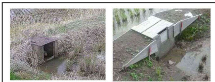
事故前の溜め升
