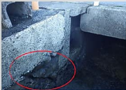
①側壁部の転倒
