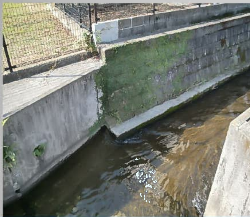
①水流摩耗による欠損
