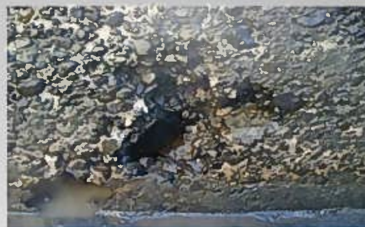
②断面欠損
