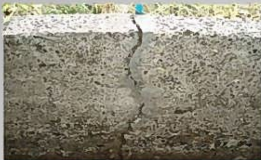
①ひび割れ
