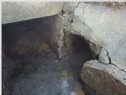
②取水部の欠損(漏水)
