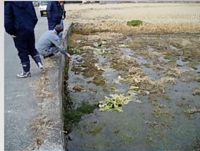
②漏水状況
