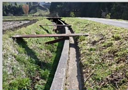
①側壁部の転倒
