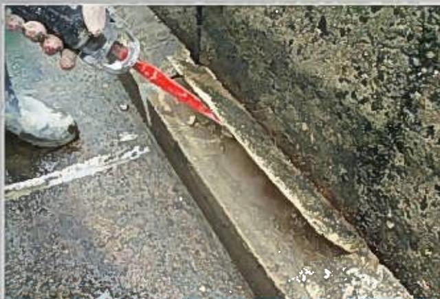
① 劣化状況
