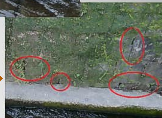
②既設石積目地の開き(漏水)
